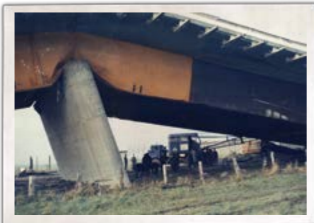
A35 Einsturz Rheinbrücke | © A.Timp
